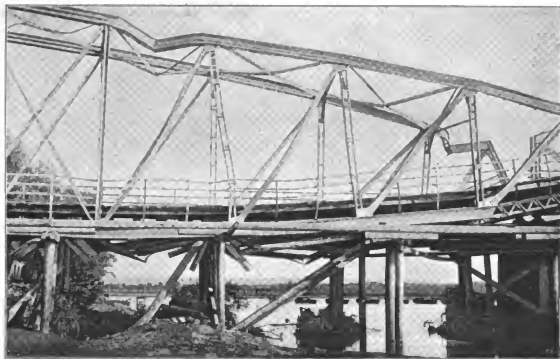
Fig. 2. Eingestürzte Strassenbrücke über die Morawa bei Ljubitchewo (Serbien).
