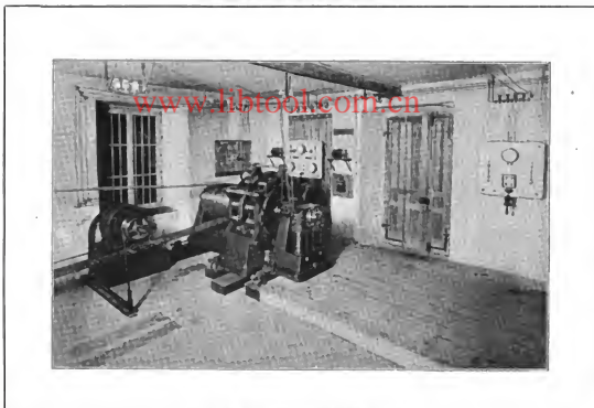
Fig. 8. 100 P.S.-Motor in der Neumühle zu Chur.
