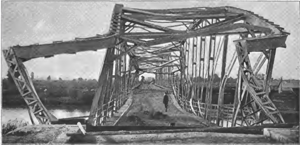
Fig. 3. Eingestürzte Strassenbrücke über die Morawa bei Ljubitschewo (Serbien).
