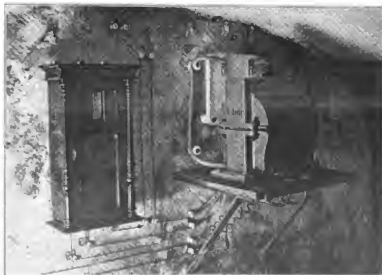
Fig. 9. Transformatoren Station (geöffnet) mit Elektrizitätszähler.
